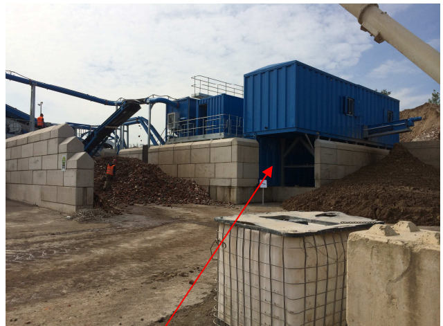
Hier wurde Testanlage installiert
